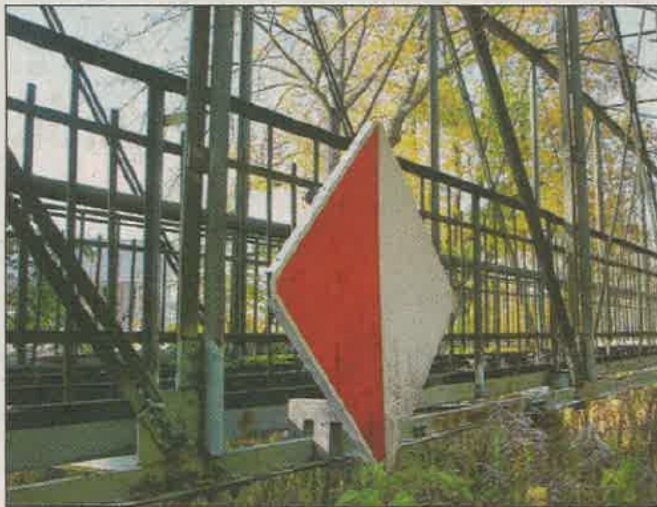
Reizvoll, aber marode: der Flakensteg, der eingezäunt am Ufer des Flakenfließes steht.
